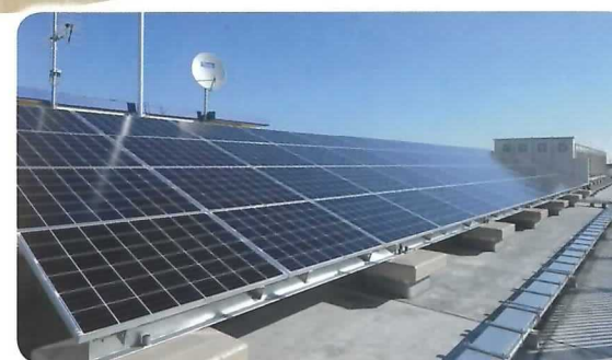
●太陽光発電設備
