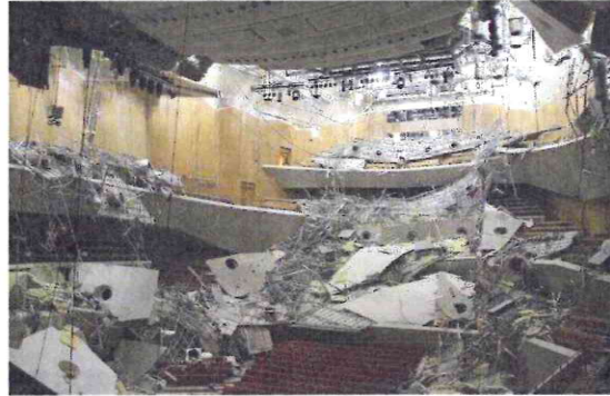
写真右：音楽ホールの天井脱落（神奈川県川崎市） （出典）国土交通省資料
