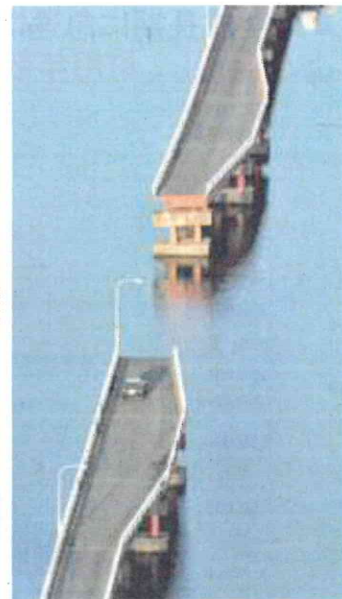
茨城県東部の鹿行大橋の落橋 （出典）東京新聞2013年2月1日
