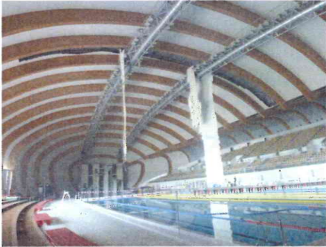
写真左：屋内プールの天井脱落（静岡県富士市）
