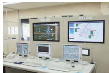
南浄水場監視制御盤
