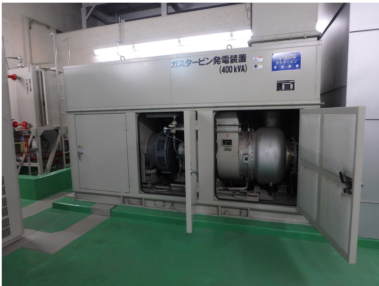
＜酒井浄水場 自家発電設備＞
