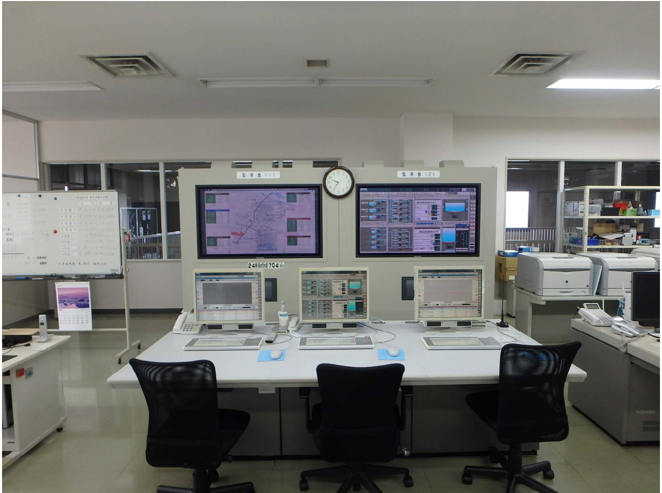
〈南浄水場 遠方監視装置〉
