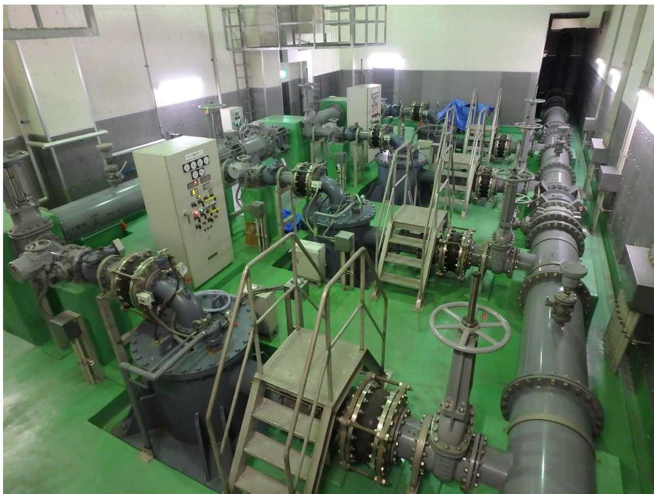
〈酒井浄水場 配水ポンプ室〉
