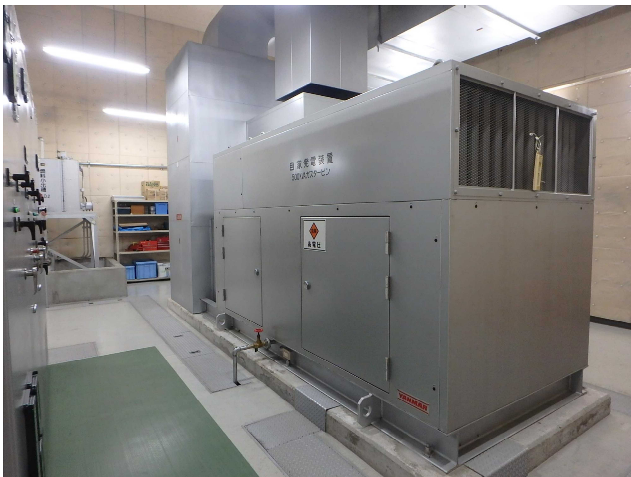
〈南浄水場 自家発電設備〉
