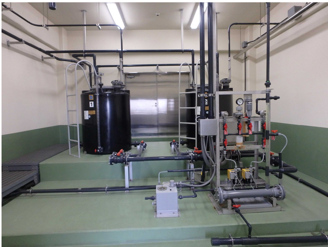
<酒井浄水場 塩素注入設備>
