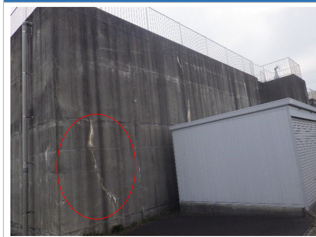
《酒井浄水場 第2配水池側壁のひび割れ》
