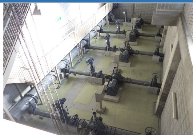
《南浄水場 5台の配水ポンプ》
