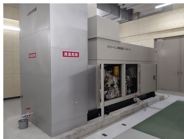
《南浄水場の自家発電設備》
