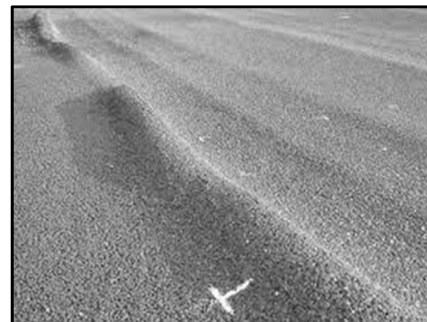
レベルⅢ わだち掘れ量 40mm 程度以上
