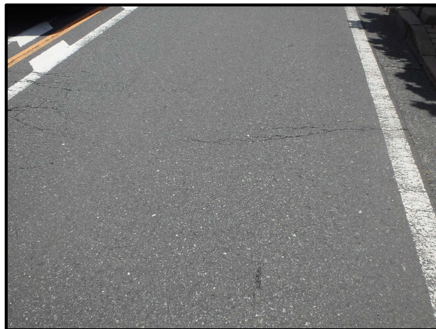
レベルⅠ ひび割れ率 0~20%程度
