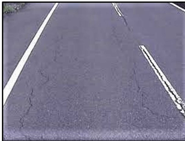
レベルⅡ ひび割れ率 20~40%程度
