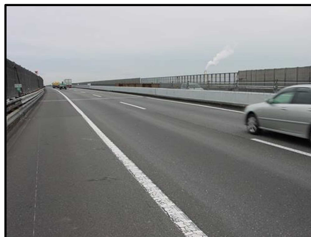
レベルⅡ わだち掘れ量 20~40mm 程度
