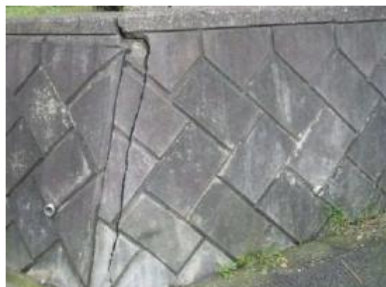
擁壁のひび割れ
