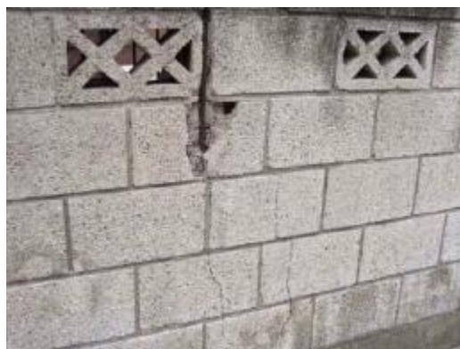
塀のひび割れ
