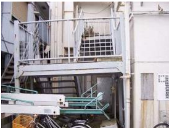
屋外階段の傾斜
