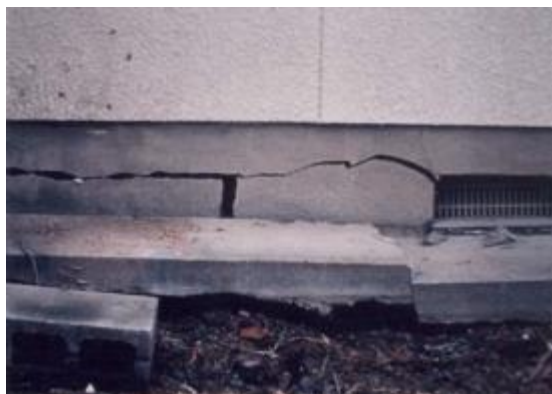
基礎の亀裂、欠損
