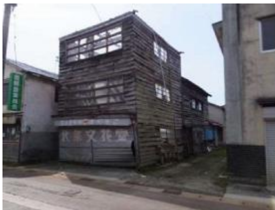
外装材の劣化
