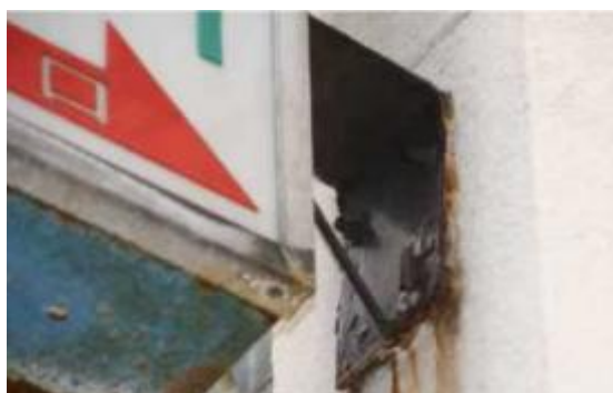
看板支持金具の腐食
