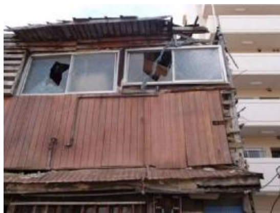
外装材、窓ガラスの破損
