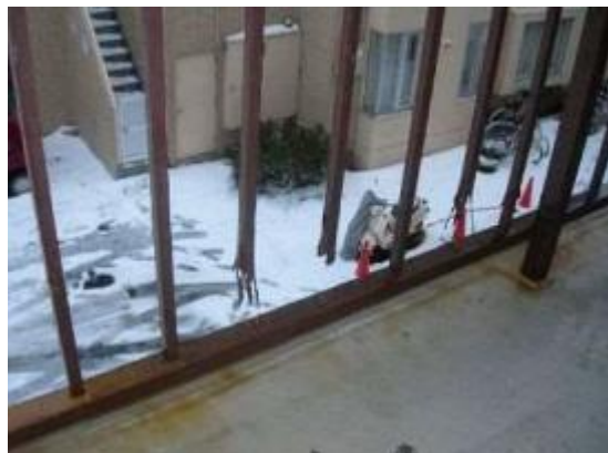
バルコニー手摺の腐食
