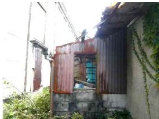
開口部等の破損
