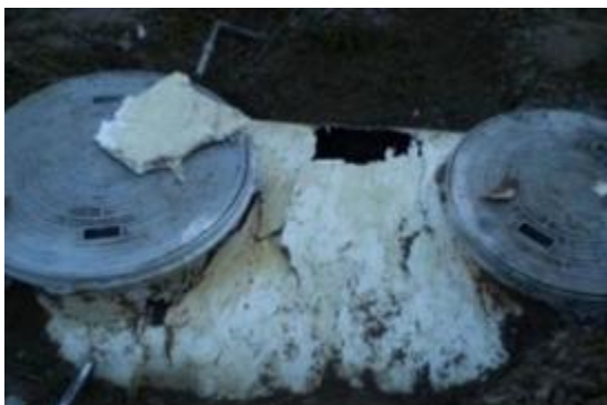
浄化槽上部の破損
