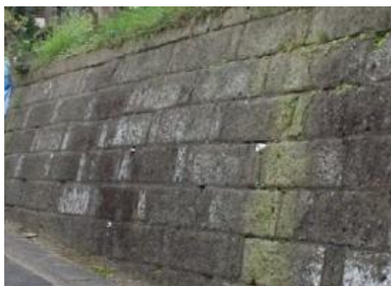
擁壁のふくらみ
