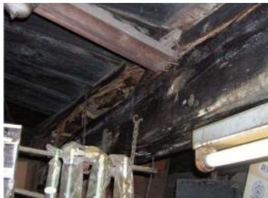
梁の破損、腐食の発生
