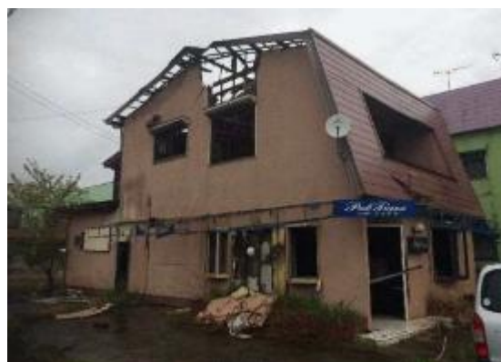
屋根の著しい破損
