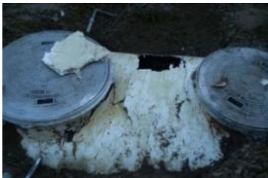
浄化槽上部の破損
