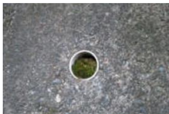
水抜き穴の詰まり
