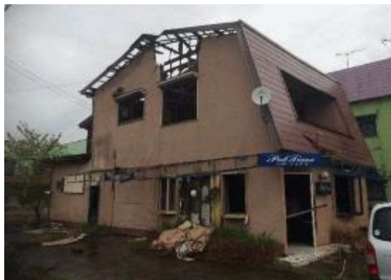
開口部等の破損
