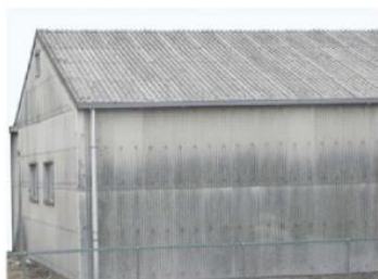
石綿使用のスレート波板
