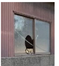
窓が割れた 管理不全空家
