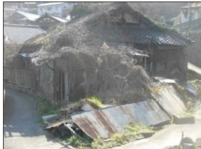
写真1 特定空家等(国土交通省資料参考) (老朽化が進み、倒壊等の危険性大)
