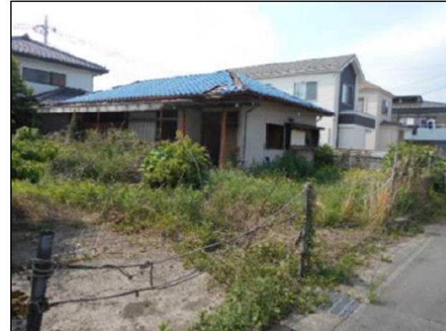
写真2 管理不全空家等(国土交通省資料参考) (雑草が繁茂、屋根の一部が欠損)
