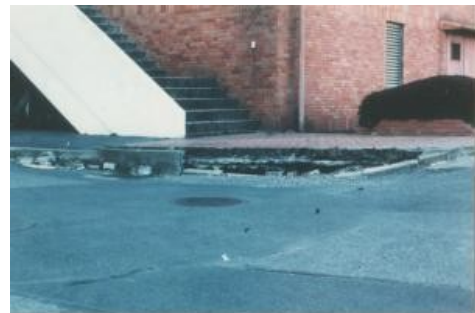
道路と建築物に生じた段差
