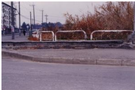
段差が生じた歩道
