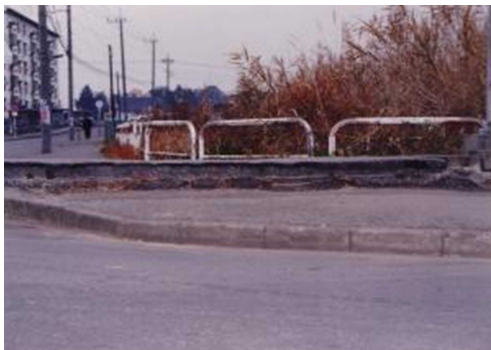
段差が生じた歩道
