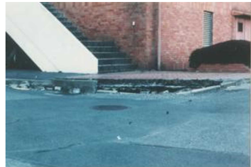
道路と建築物に生じた段差
