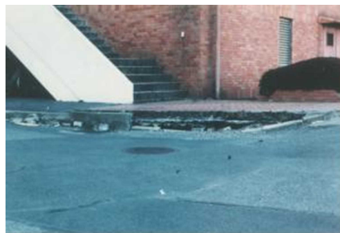
道路と建築物に生じた段差
