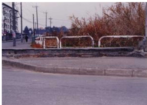
段差が生じた歩道
