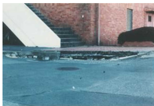
道路と建築物に生じた段差
