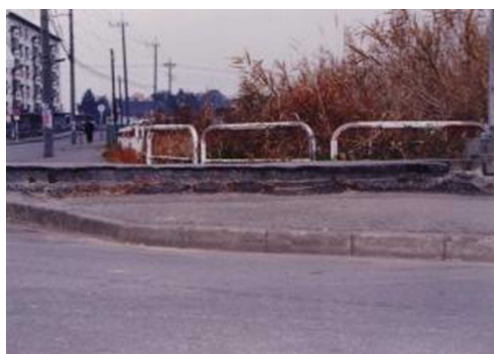
段差が生じた歩道
