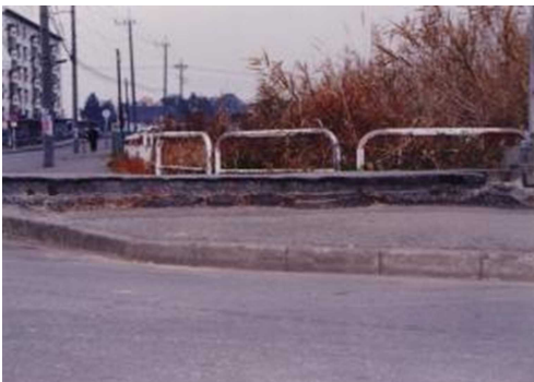
段差が生じた歩道
