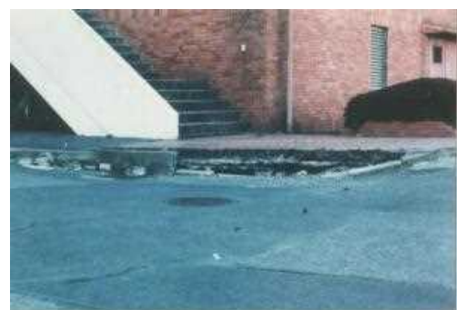
道路と建築物に生じた段差
