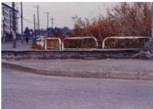
段差が生じた歩道
