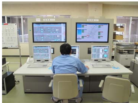
＜南浄水場 遠方監視装置＞
