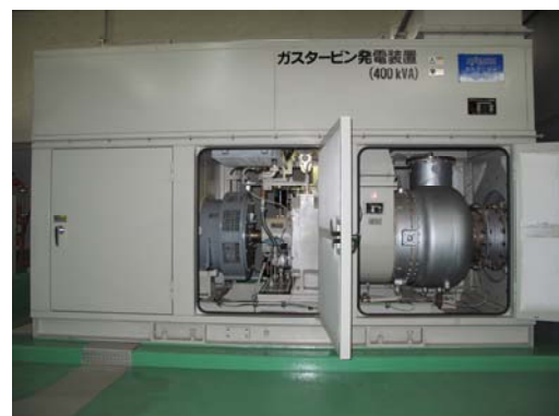
<酒井浄水場 自家発電設備>
