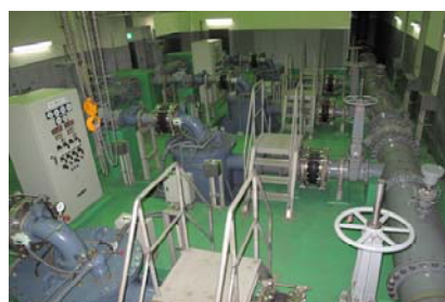
＜酒井浄水場 配水ポンプ室＞
