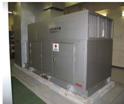
＜南浄水場 自家発電設備＞
