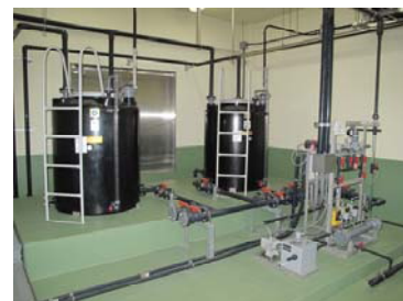
<酒井浄水場 塩素注入設備>
